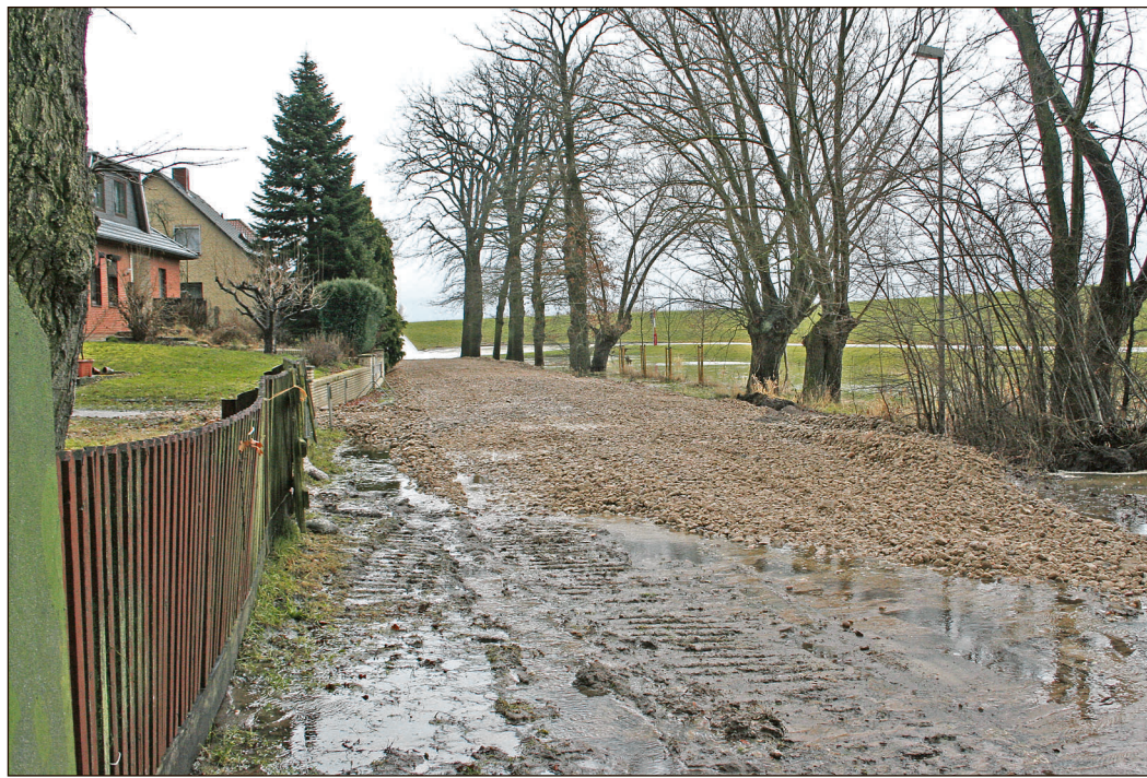
Über Nacht wurde der Elbweg mit 500 t Steinen und Mineralgemisch zur Sicherung aufgefüllt.
