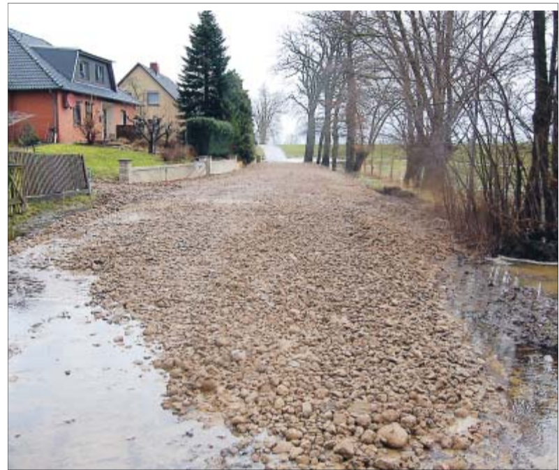
Der Elbweg in Alt Wendischthun ist kaum noch befahrbar. 500 Tonnen Steine haben die Hilfskräfte verbaut, um ein Anheben der Straße durch Qualmwasser zu verhindern. Schwere Lkw haben die Probleme offenbar verursacht.
