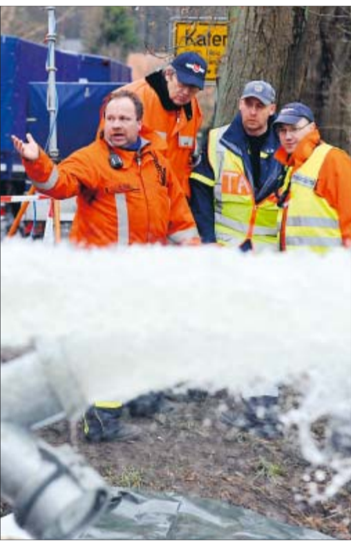
Feuerwehr und Technisches Hilfswerk haben den Kateminer Mühlenbach gesperrt, pumpen das Wasser über die Straße in Richtung Elbe. Foto: dpa
