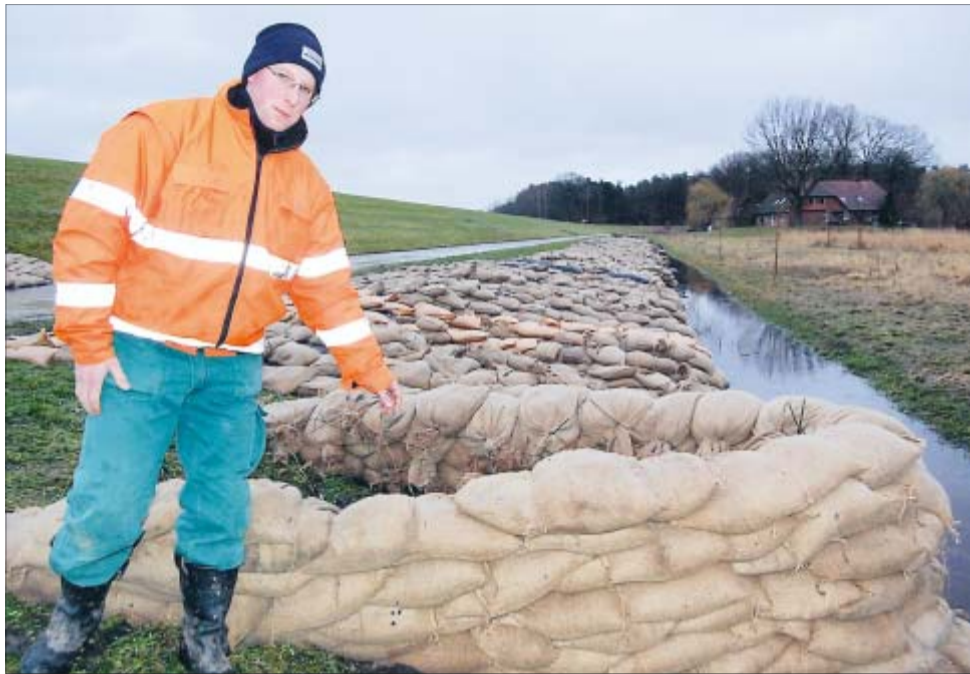
Jan Schulz war als Deichwache unterwegs, als er die Ausspülung im Deichfuß entdeckte. Mit einem sogenannten Fangedamm wurde die undichte Stelle gesichert. Auch gestern Abend mussten die Bleckeder Wehren noch einmal ausrücken um instabile Böschungsbereiche zu sichern. Fotos: kre
