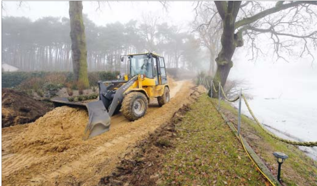
Die Stadt Bleckede lässt in Alt Garge Notdämme aus Sand gegen das Hochwasser aufschütten. Der Ortsteil ist die letzte Deichlücke an der Elbe zwischen Cuxhaven und Schnackenburg. Foto: t & w
