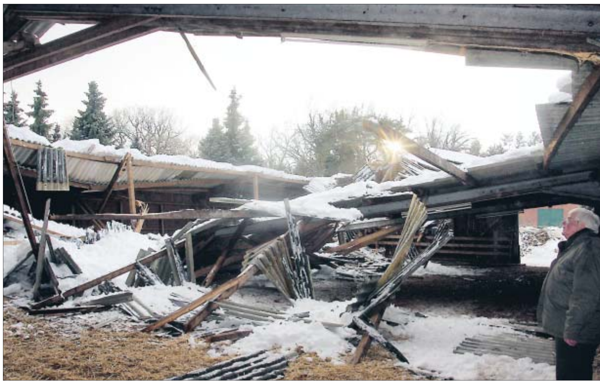
Hofbesitzer Wilfried Kappe-Radel ist geschockt: Unter der Last gewaltiger Schneemassen ist das Dach seiner 1968 gebauten Reithalle eingestürzt. Foto: ki
