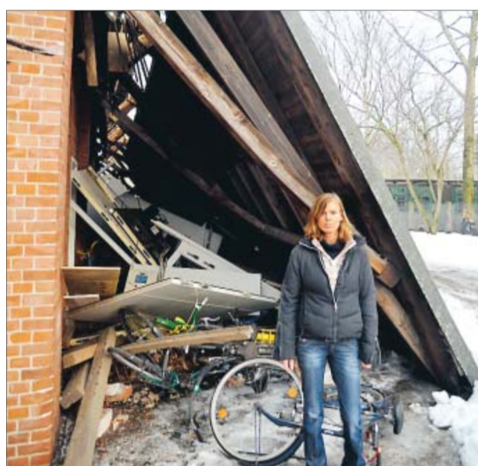
Oben: In Mechtersen schreckte Cathrin Köhler nachts um eins aus dem Schlaf, das Vordach der Scheune war abgebrochen. Sie muss nun die Dachkonstruktion des Gebäudes sichern lassen.
