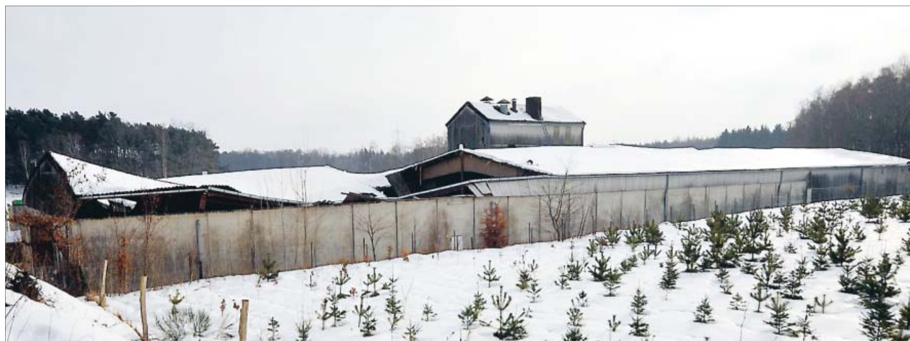
Ein Teil des Dachs der Raiffeisen-Halle in Embsen ist eingekracht, geschätzt bis zu 75 Kilo Schnee pro Quadratmeter liegen auf den Dachflächen.
